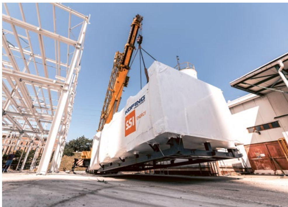
Instalace plynového horkovodního kotle v areálu Teplárny Karviná.
